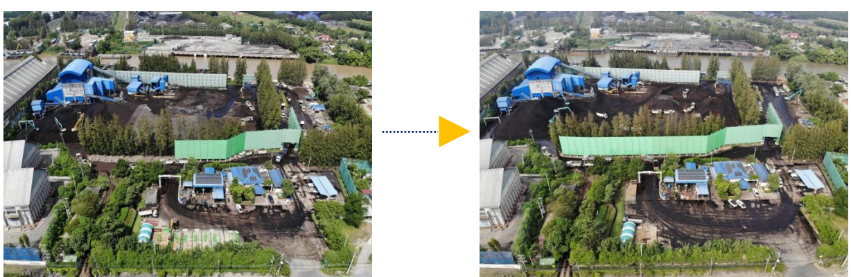
รูปภาพแสดงความคืบหน้าการก่อสร้างแนวกันลมถาวร (Wind Break) ที่ศูนย์จำหน่ายถ่านหิน จังหวัดพระนครศรีอยุธยา
