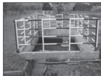
ระบบบ่อดักตะกอน
